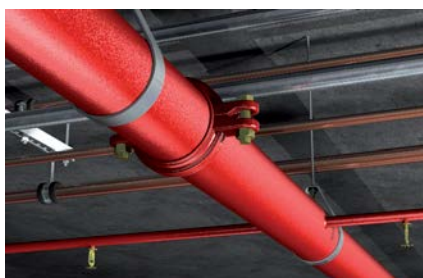
Системы аварийного пожаротушения
